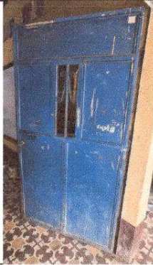
Foto1: Mantenimiento a estructura (lijado, cambio de tubo, cepillado, sujecioens, aplicacián de pintura).
