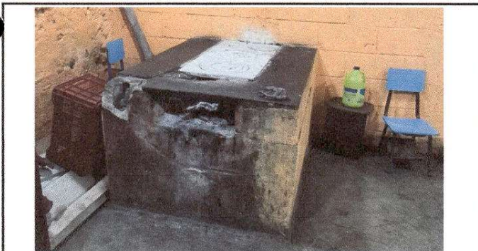
Foto 17: Sustrucción de estufa rural (completa) incluye chimenea y plancha de metal. Instalación de azulejo en estufa rural.
